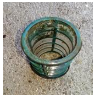
Εικόνα 58: Φίλτρο με ακαθαρσίες
