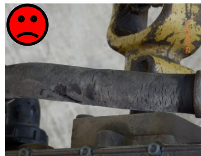
Εικόνα 27: Αγωγός σε κακή κατάσταση
