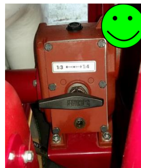
Εικόνα 96: Κιβώτιο ταχυτήτων για διακοπή της λειτουργίας του ανεμιστήρα
