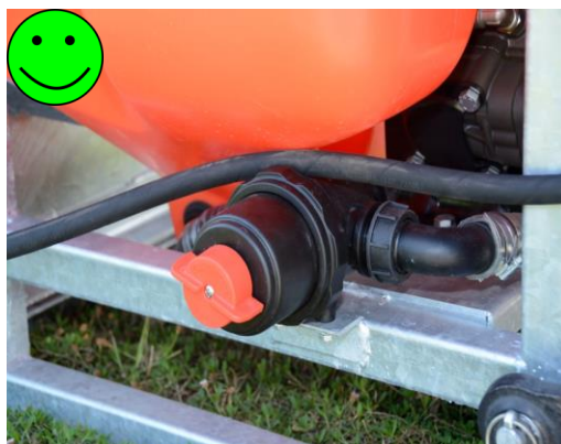
Εικόνα 55: Το κυρίως φίλτρο, το οποίο είναι τοποθετημένο μεταξύ του βυτίου και της αντλίας
